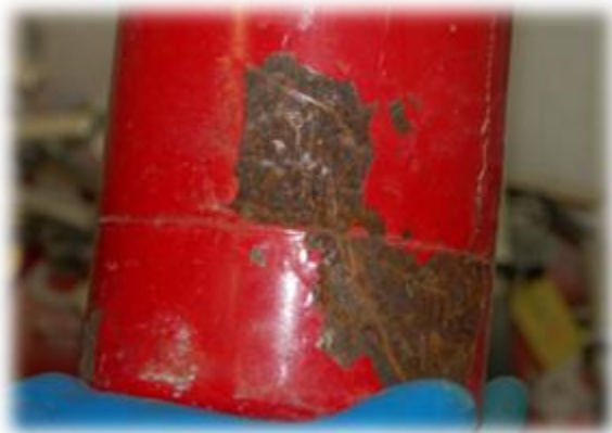
54.att. Korpusa korozijas bojājumi
